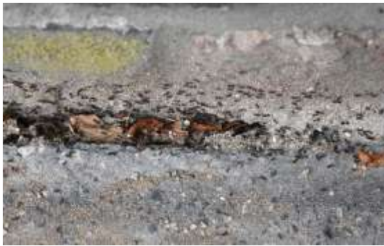
Abb. 4 - Nestausgang in einem Spalt im Asphalt
