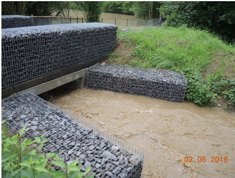
Abb. 5: Schadensbild Hochwasserereignis Schwanenteich im Ortsteil Bad Bodendorf im Jahr 2016
