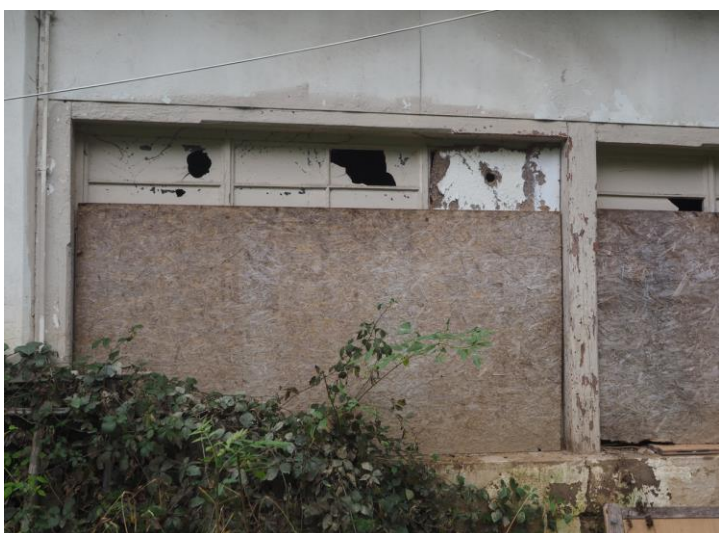
Abbildung 14: Rückseite des Technikgebäudes mit defekten, abgedeckten Fensteröffnungen
