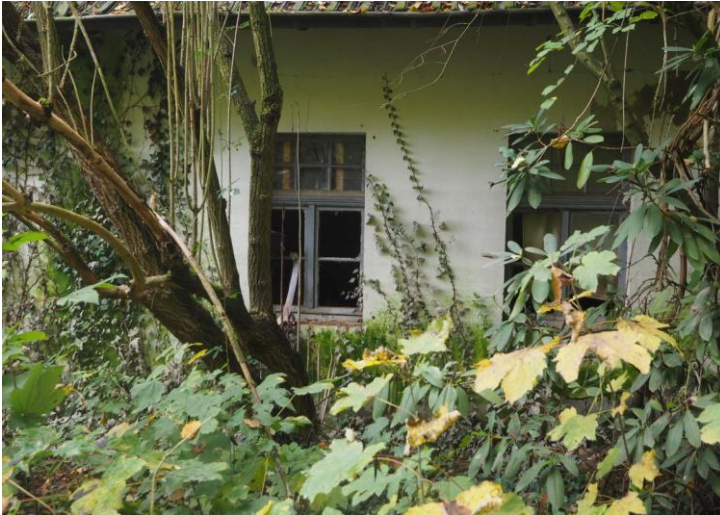
Abbildung 16: Rückseite des Technikgebäudes mit offenen Fenstern, die teilweise von innen abgedeckt sind
